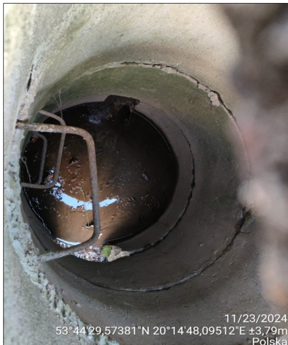
zdj. 9 dno studzienki z włączeniem sączka drenażowego
