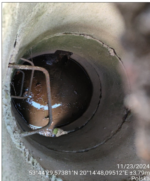
zdj. 9 dno studzienki z włączeniem sączka drenażowego
