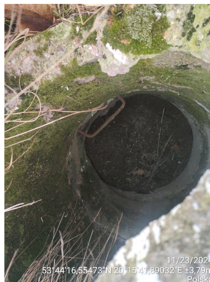
zdj. 21 dno studzienki zasypane urobkiem
