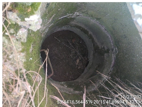
zdj. 23 dno studzienki zasypane urobkiem
